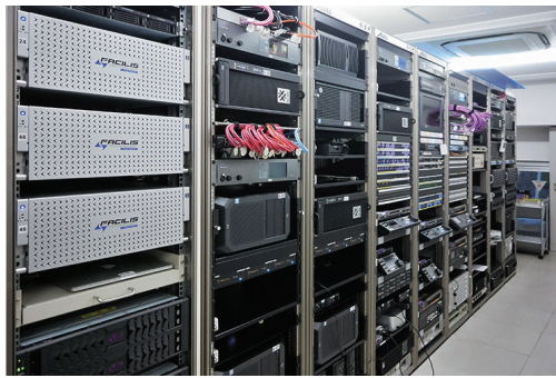
すっきりとまとまったマシンルーム
